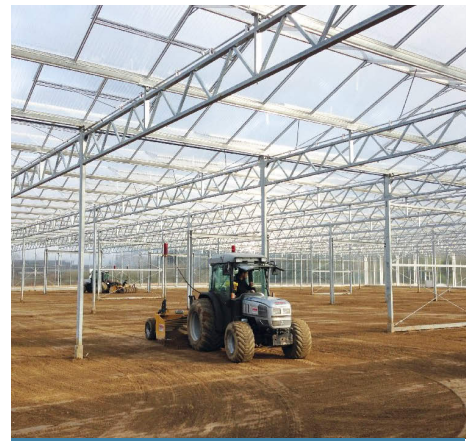
Der Boden ist wieder verfestigt
