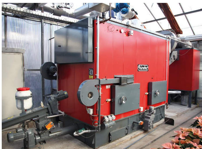
Der 840-kW-Holzpelletkessel beheizt den ganzen Betrieb
